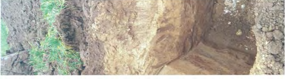
Bild 4: Schurf 4 (Sch 4) bis in eine Tiefe von 3,3 m unter GOK in der Sohle
